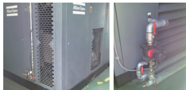
コンプレッサーの排熱を回収し、オフィスの暖房に使用。
