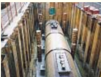
◀2重構造の地下タンク
