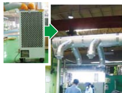
冷風機を床置型から集中管理型にすることで空調の効率化・省エネを実施(AFA:中国)
