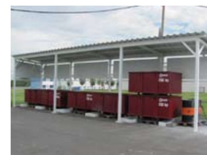
廃棄物コンテナに付着した油が雨などで流出するのを防止するため、集積場に屋根を設置(AIC:チェコ)
